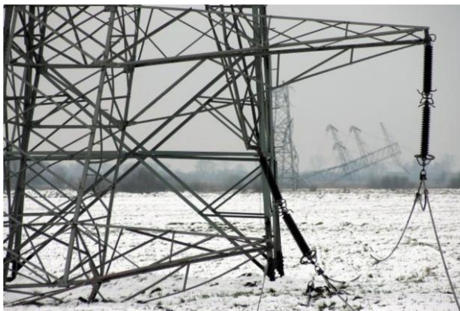
Ryc. 1. Zerwane linie energetyczne w rejonie Szczecina 7.04.2008 r.
